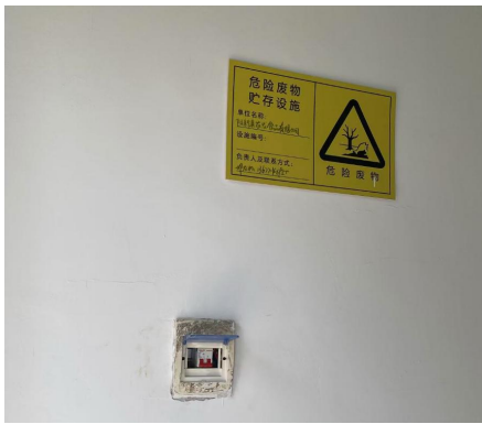
危险废物暂存间标识牌
