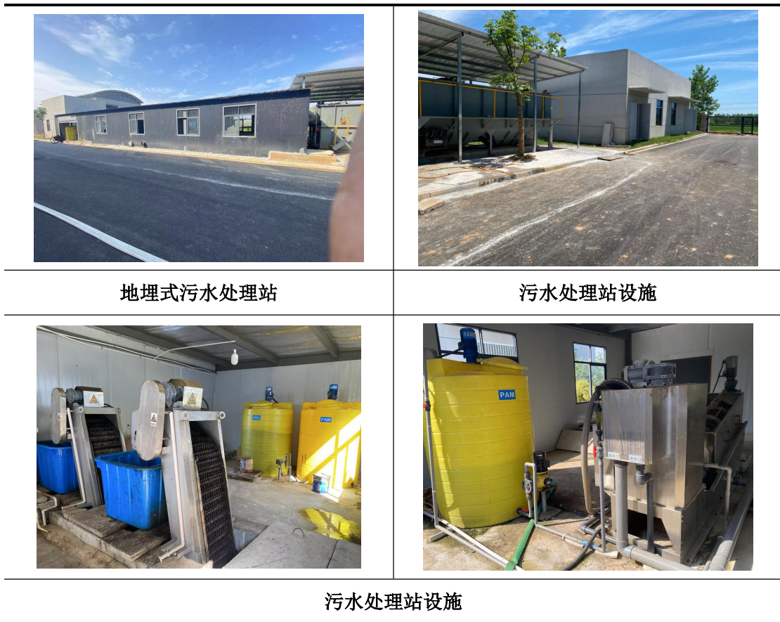
图 4-2 废水治理设施图片
